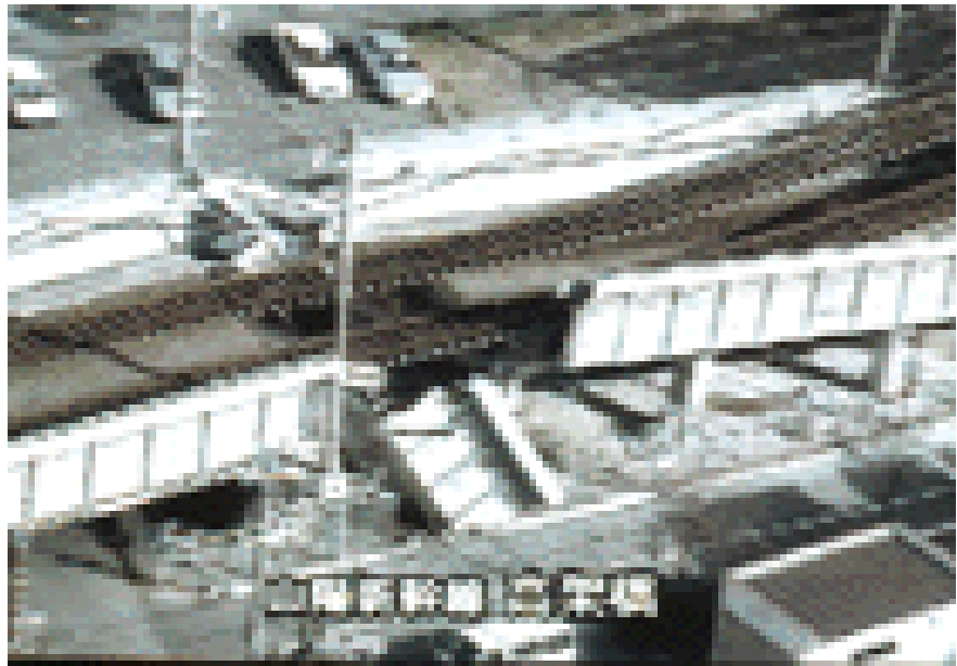
圖 3-5 山陽新幹線高架橋鋼骨斷裂情形
