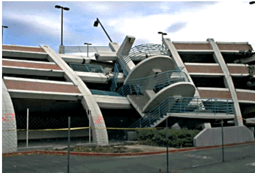
圖 3-4 洛杉磯市立停車場倒塌情形
